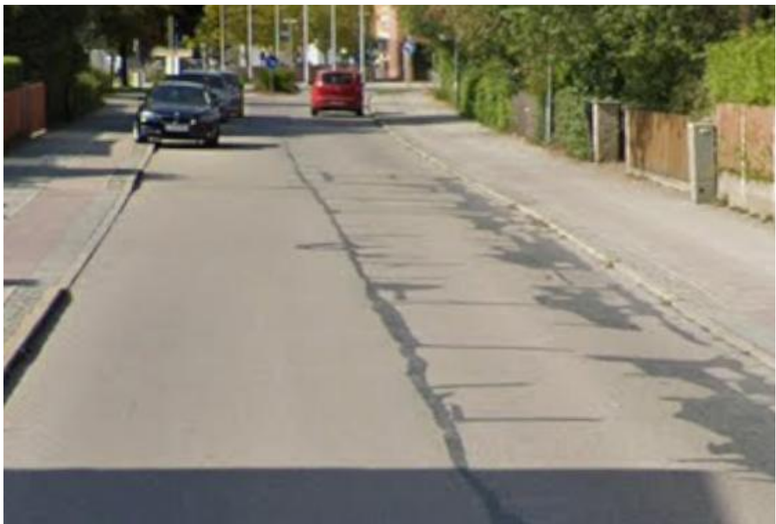
Fahrbahnsenkungen im Bereich des Rinnsteins, Rissverfüllungen (gelb-rot), Westlich der Kreuzung Friedenstraße, Blickrichtung Westen (Quelle: Google Maps)
