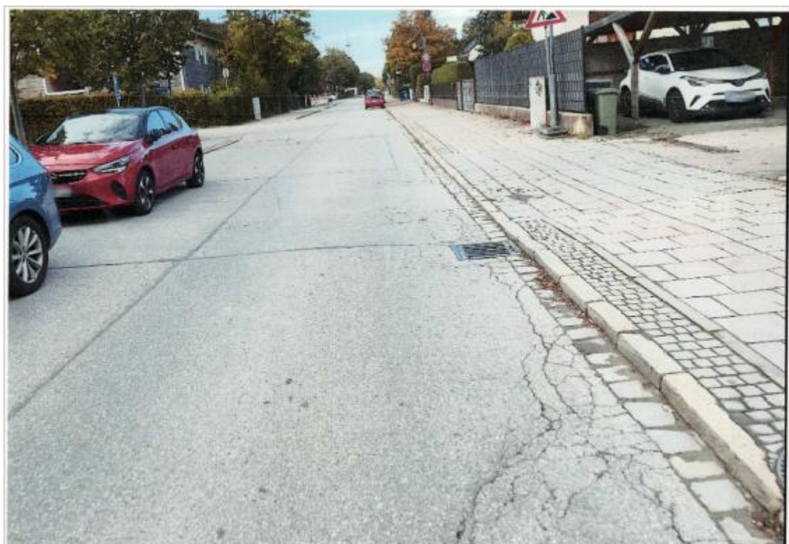
Schadstellen (Rissbildungen) im Asphaltbereich und im Bereich der Einlaufschächte (rot), Höhe Bodmerstraße, Blickrichtung Westen
