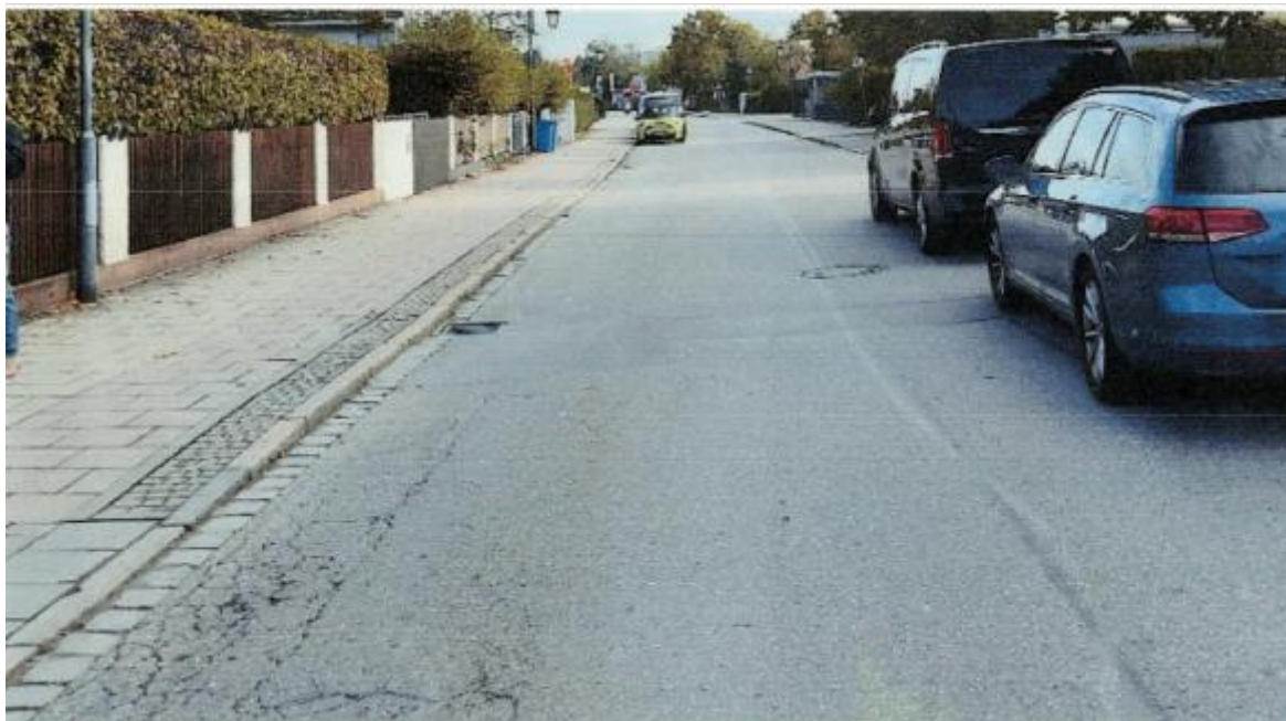
Schadstelle im Asphaltbereich (gelb-rot), Höhe Bodmerstraße, Blickrichtung Osten
