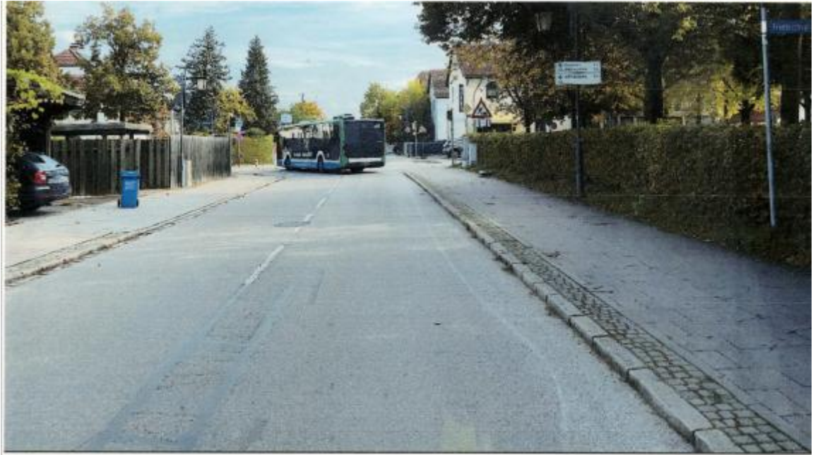
Spurrillen und Rissverfüllungen (gelb-rot), Höhe Friedrichsplatz, Blickrichtung Osten
