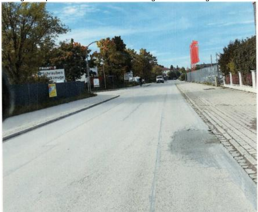
Schadstelle im Asphaltbereich (gelb), Höhe Xaver-Münch-Straße, Blickrichtung Westen
